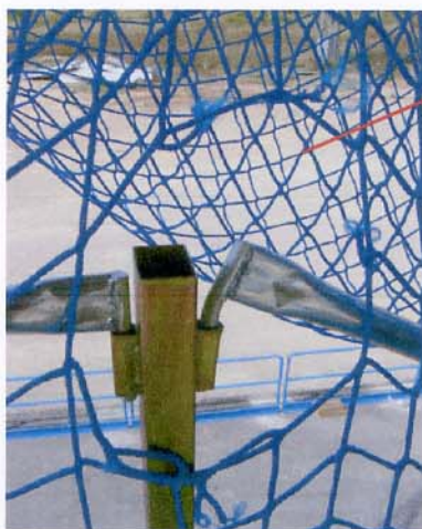
Rotura de la Red
